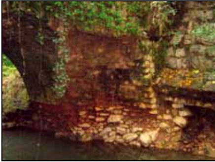
Слика 4. Ошћећење низводне сџране лијевог ојорца
