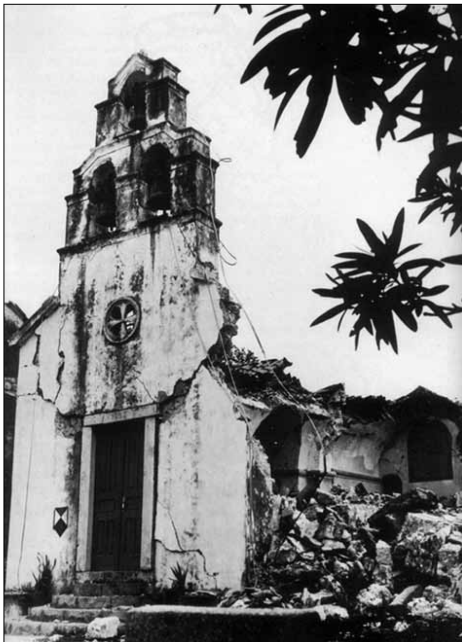
Sl. 1. Crkva sv. Ivana - oštećenja od zemljotresa
