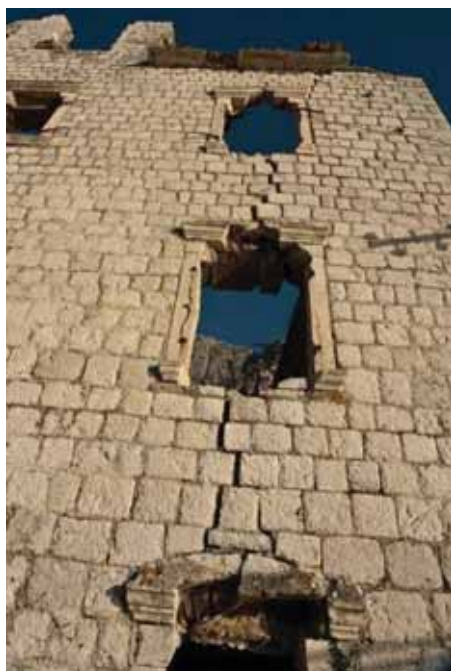
Изглед пукотине на југозападном углу главне куће
