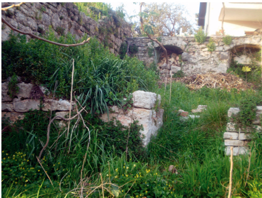
Sl. 10 Ruševni ostaci kuće sa istočne strane dvorišta
