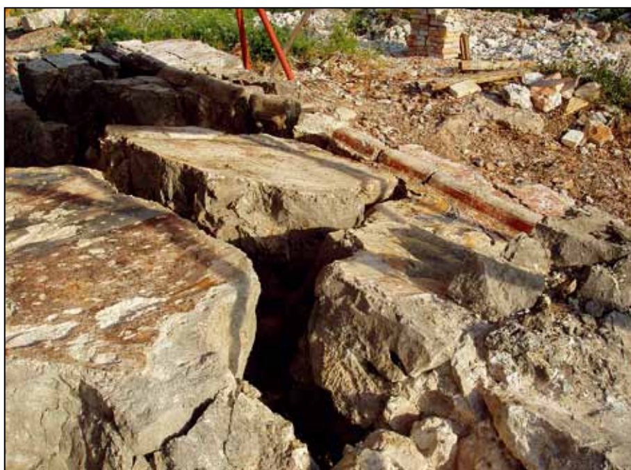
Sl. 6. Srušeni južni zid crkve
