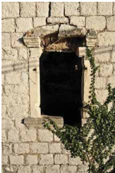
Изглед оштећеног прозора у нивоу првог спрата на главној фасади
