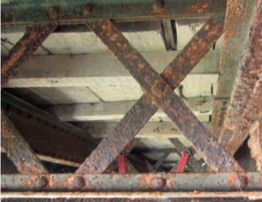
Растојање на споју дијагонала и доњег појаса, општа површинска корозија
