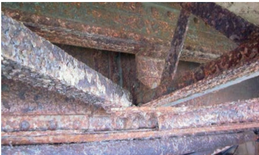
Љуштење, раслојавање усљед изразите корозије
