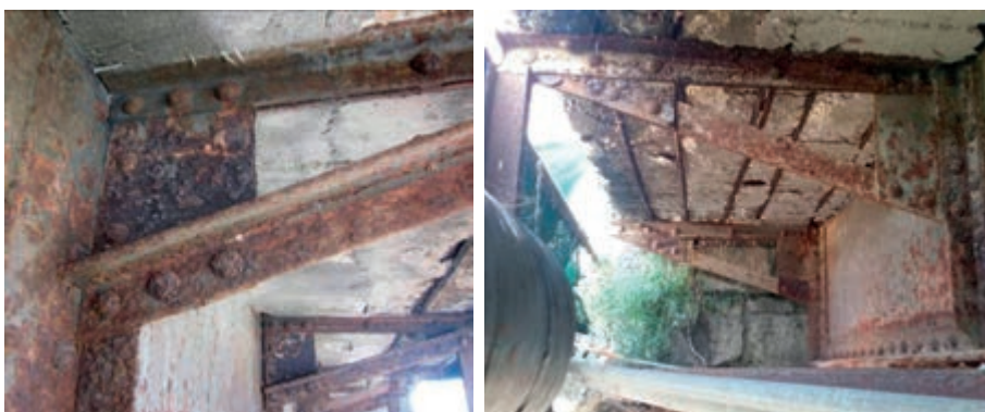
Детаљ конзолног носача, корозија, љускање Корозија, љускање површинског дела
