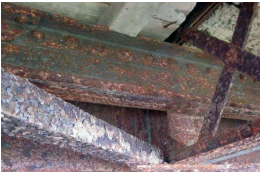
Општа корозија, љускање и отпадање чека
