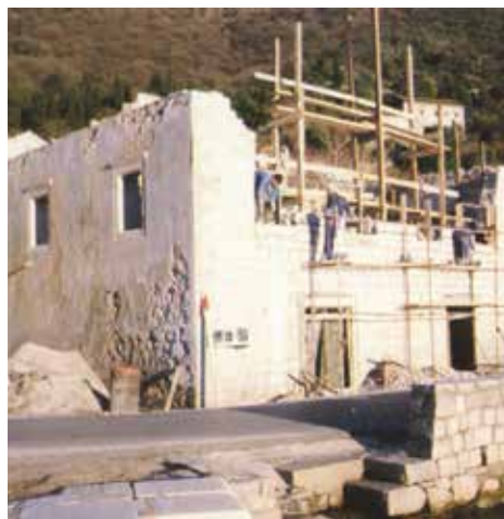
Slika 53. Zbog izletanja frontalni zid sa vidionicom i visinom od 9 m morao je biti srušen.
