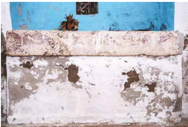
Слике 12, 13. Оштећења малтерне облоге изазвана капиларном влагом
