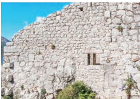
Слика 32. Различити слојеви зидања на ист. фасади касарне, прозор на мјесту ранијег улаза у одбрамбени појас
