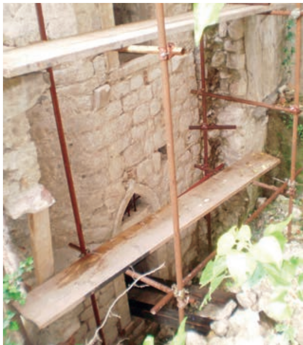
Fot. 8. Zakošenje jugozapadnog ugla zvonika na spoju sa romaničkom zgradom samostana
