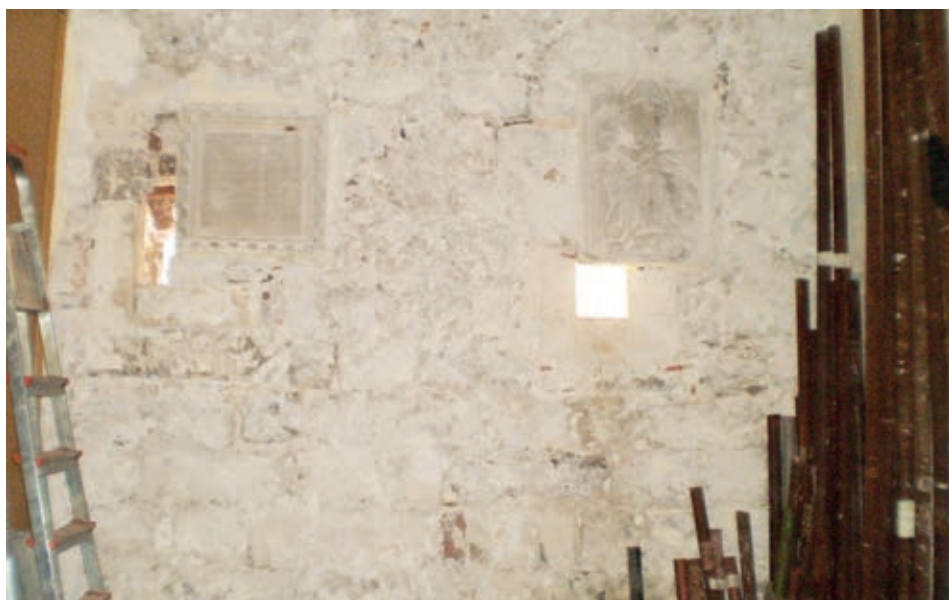
Fot. 18. Položaj natpisa iz 1372. g. i reljefa Sv. Antona opata - u unutrašnjosti Crkve Sv. Josipa (na mjestu starijih otvora na južnoj fasadi Crkve Sv. Josipa)
