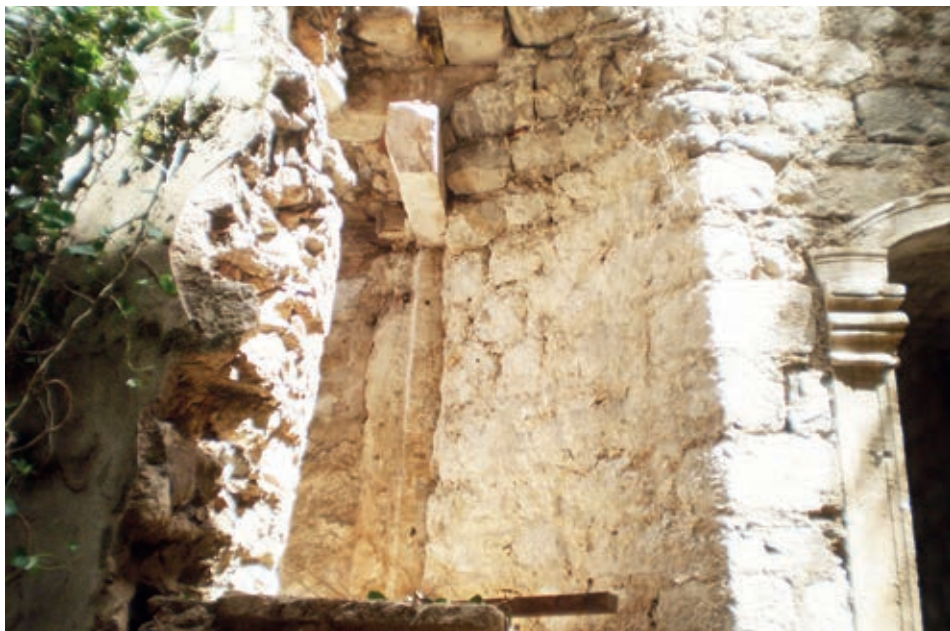
Fot. 6. Sjeverni dio oštećenog romaničkog prozora na II spratu romaničke zgrade samostana - nakon uklanjanja zidane ispune
