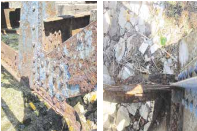
Слика 11. и 12. Детаљ чвора у оси 2, страна Б; општа површинска корозија; раслојавање и љускање заштитног слоја; редукција пресека челичних профила; кидање профила услед израстите корозије. Детаљ ослањања доњег појаса на лежиште које је потпуно уништено у овом дијелу (страна А); деформација профила; губитак попречног пресека; површинска корозија.
