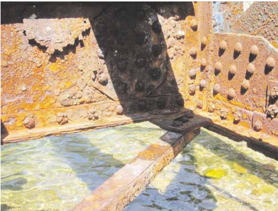
Слика 14. Љускање и отпадање дјелова профила изазваних корозијом
