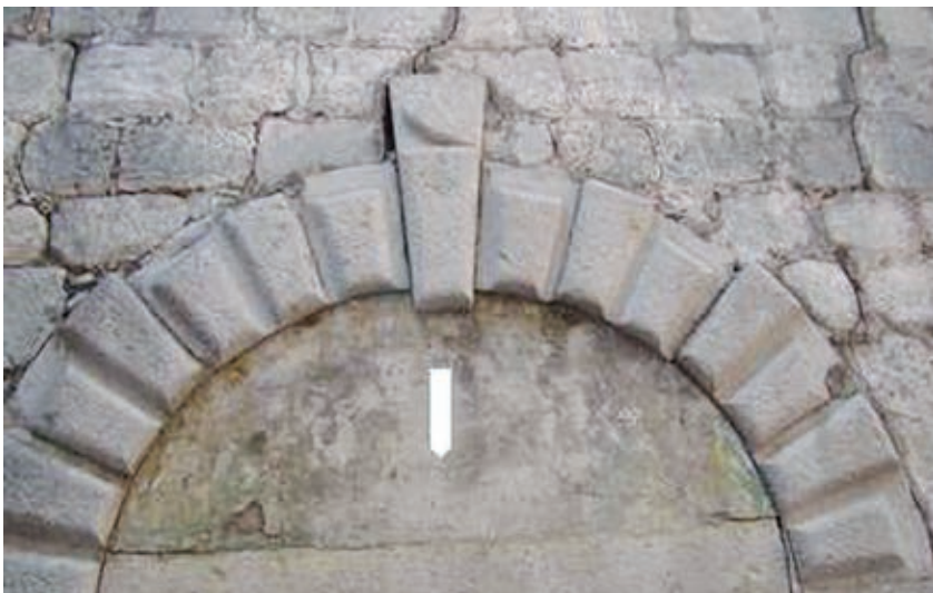
Sl. 3 Detalj iznad ulaza u prizemlju lođe, obrada polukružnog dijela portala, malterisanjem i bojenjem rumenožutom bojom, koja je tokom vremena izgubila intenzitet
