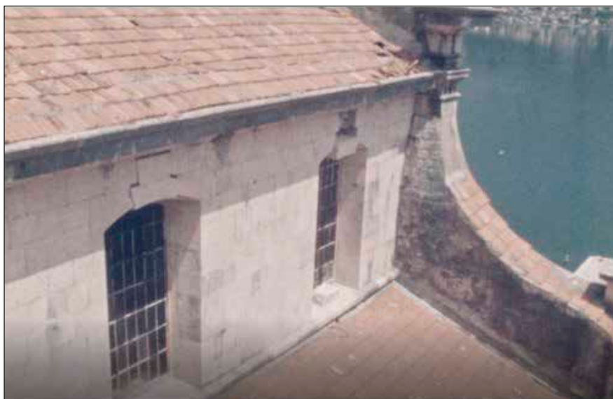
Sl. 11 | Pogled na jugoistočni ugao crkve sa oštećenjima izazvanim u zemljotresu
