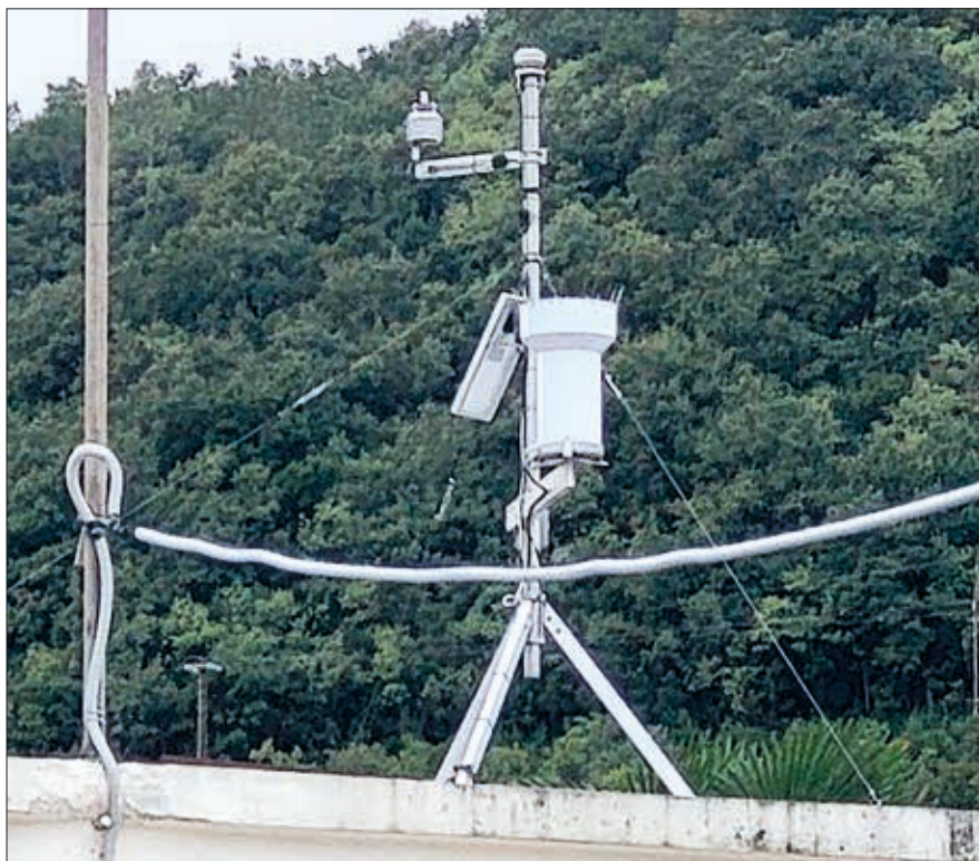
Сл 3.1. Кишомјерна станица на крову каптаже Опачица, постављена марта 2023
