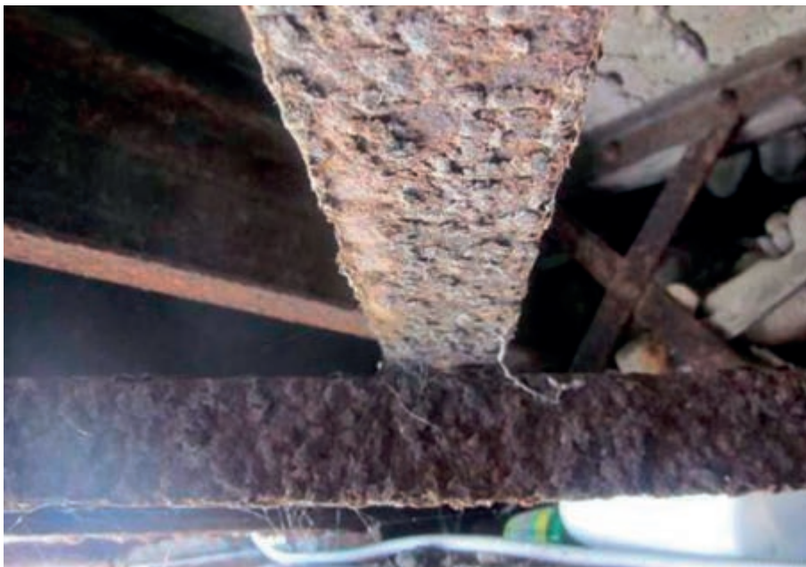
Изражена корозија, љускање, редуција попречног пресека, бубрење
