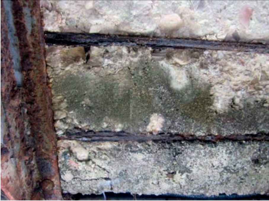
Корозија арматурних шипки, недовољна дебљина заштитног слоја бетона
