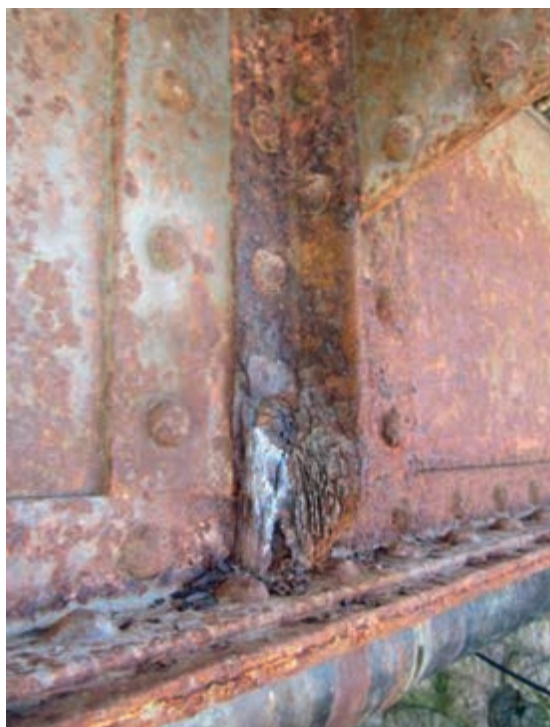
Општа површинска корозија, љускање челика захваћеног корозијом, раздвајање лимова
