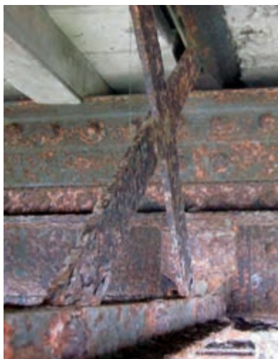
Површинска корозија, љуштење
