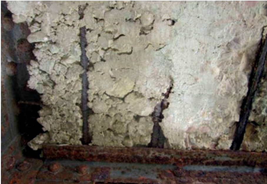
Корозија арматурних шипки, сегрегација бетона, отпадање бетона
